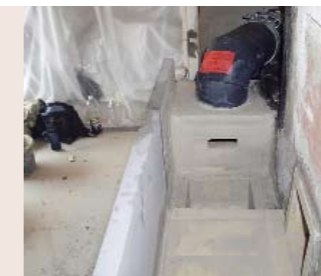
Das Rauchrohr ist an den gemauerten Zug angeschlossen, inklusive Bypass (Gasschlitz).
