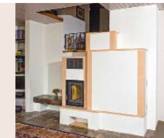
Die neu gebaute Anlage hat einen stattlichen Wirkungsgrad von über 80 Prozent.
