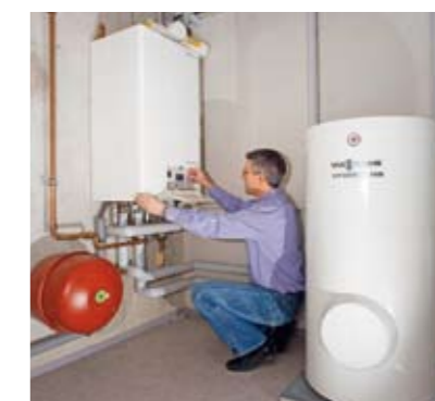
Die Gastherme im Heizkeller wärmt das Heiz- und Brauchwasser.
