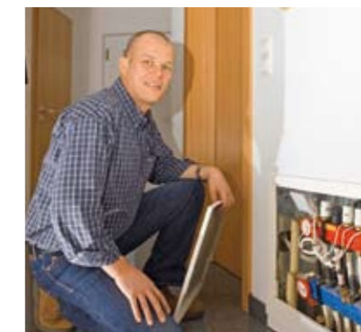
Kachelofen- und Luftheizungsbaumeister Stefan Ernst vor dem Verteilerschrank. Von hier aus werden die einzelnen Räume mit Warmwasser angefahren.
