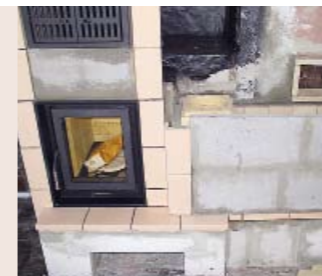
Gut ablesbar ist der Zugverlauf Richtung Kaminanschluss. Die Keramik stammt von Jasba.
